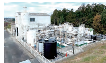
岡山工場の排水処理設備
