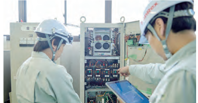
電源機器の保守・点検サービス
