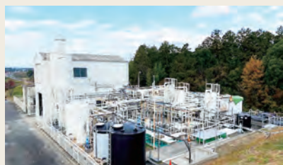
岡山工場の排水処理設備
