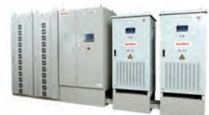
当社旧大阪工場に設置されたVPP実証用パワーコンディショナー
