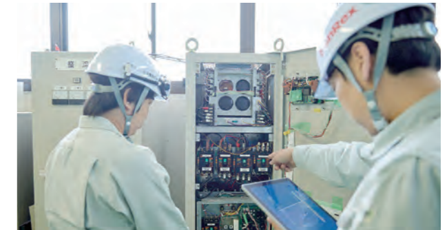
電源機器の保守・点検サービス
